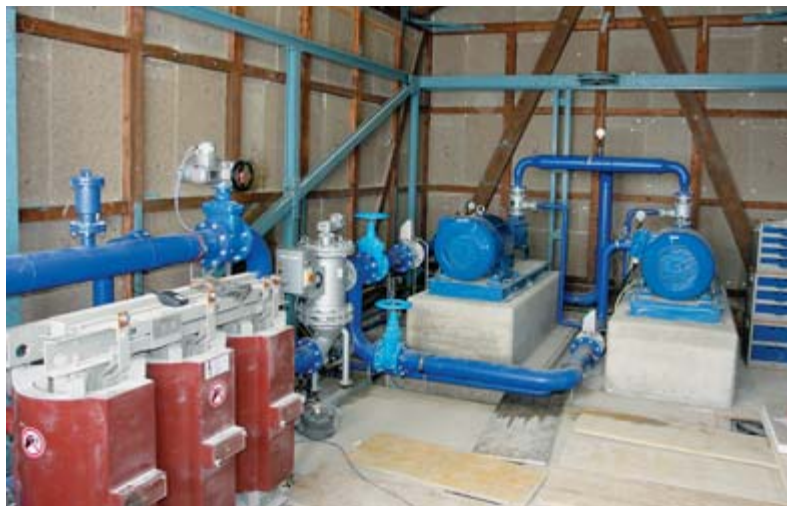
Die leistungsfähigen Pumpen können über Frequenzumrichter bedarfsabhängig geregelt werden.
