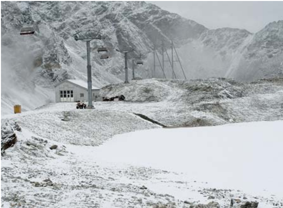
Die neue Pumpstation der vollautomatischen Schneeanlage wurde samt Steuerung in der bestehenden alten Mittelstation des ehemaligen Gletscherlifts untergebracht (2 860 m). Rechts das Naturreservoir mit geschätzten 7 000 m 3 Speichervermögen. Fotos: tb
