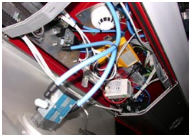
Dezentrale SPS-I/O-Einheiten in den Dachgurten für die Tür- und Abteilsteuerng.
