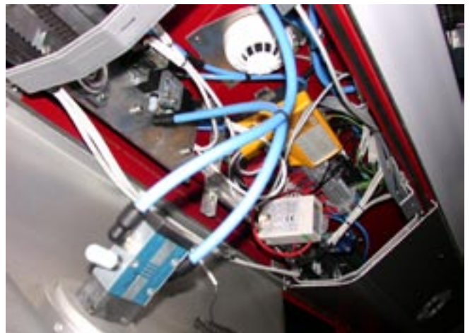
Dezentrale SPS-I/O-Einheiten in den Dachgurten für die Tür- und Abteilsteuering.
