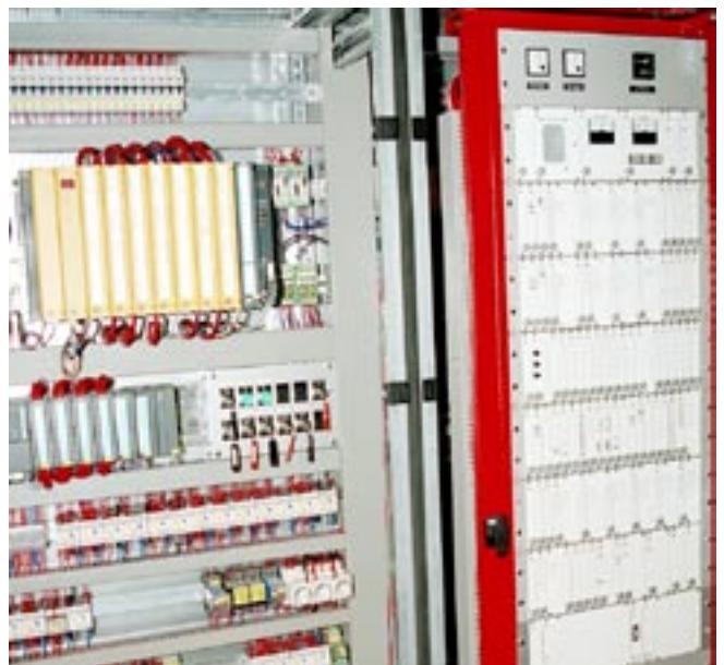
Einblick in den Steuerschrank. Links die fehlersichere PSS (gelb), rechts die Fernüberwachungsanlage.
