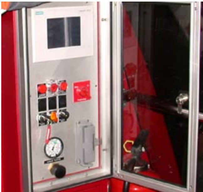
Talseitiger Notfahrstand mit Touchpanel und wichtigen Steuerungs- und Signalisationseinrichtungen. Der Steuerkasten ist abschliessbar.
