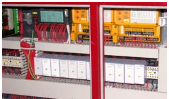
Steuerpanel im vorderen Führerstand mit PSS I/O-Modul, S7 und allgemeiner Wagenelektrik. Der gesamte Aufbau ist servicefreundlich und übersichtlich angeordnet.
