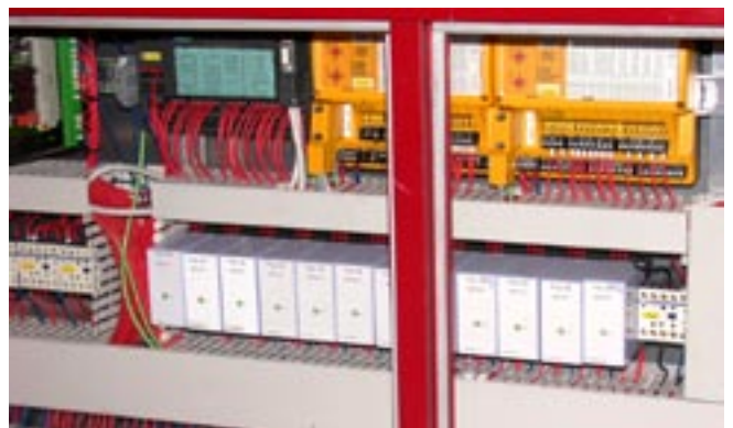
Steuerpanel im vorderen Führerstand mit PSS I/O-Modul, S7 und allgemeiner Wagenelektrik. Der gesamte Aufbau ist servicefreundlich und übersichtlich angeordnet.
