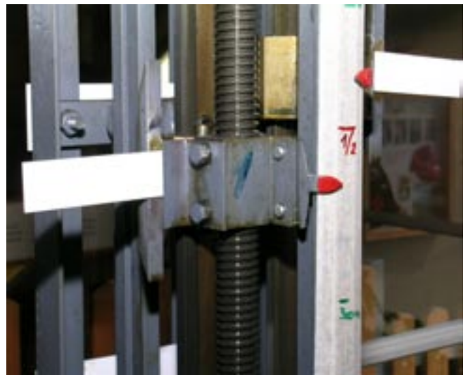
Der mechanische Stellungenanzeiger erfüllt noch alle Anforderungen der Vorschriften.
