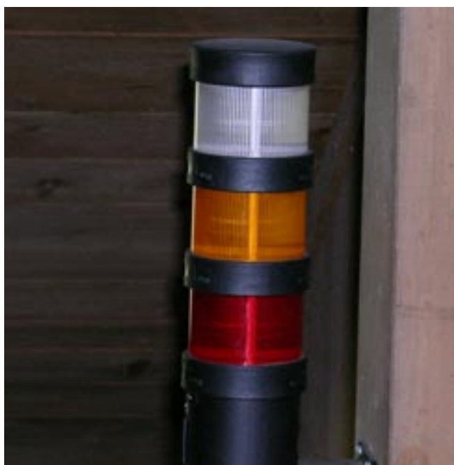
Speziell eingerichtete Lampensäulen zur Information des Betriebspersonals.
