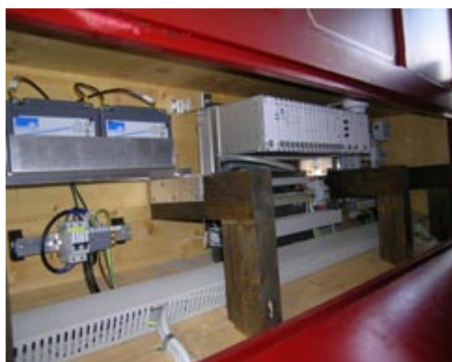
Ladeeinrichtung für die Bordbatterien, Fernüberwachungsanlage (FUA) und Brandmeldeanlage in der Rückseite des Führerstandes „versteckt“.
